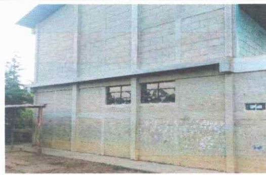
Foto 6: Se observa que las paredes exteriores están sucias y no están pintadas.
