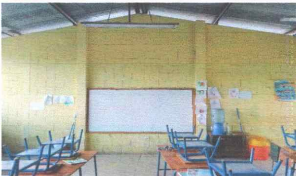
Foto 5: Se observa la necesidad de pintar las paredes interiores de las aulas.
