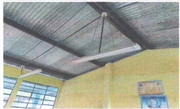
Foto 4: Se observa el estado de las lamparas que necesitan ser cambiadas.
