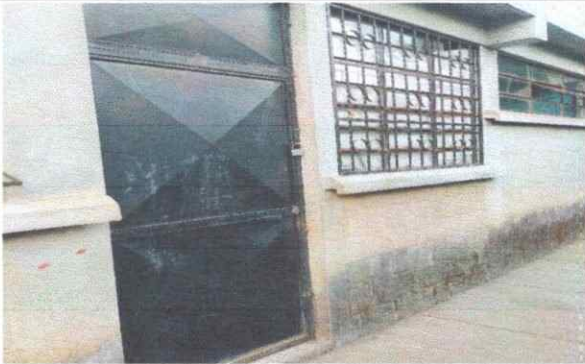
Foto 3: Se observa el mal estado de las puertas y paredes del establecimiento.
