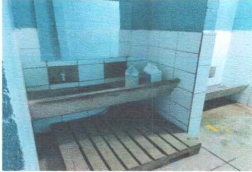
Foto1: Se observa el mal estado de los servicios sanitarios de hombres.
