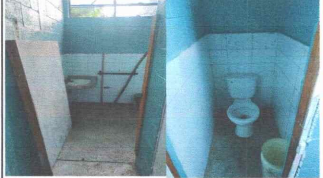
Foto 2: Se observa el mal estado del servicio sanitario de las niñas.
